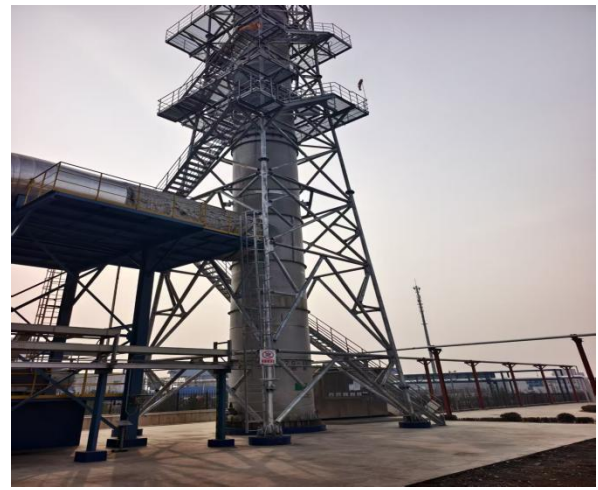
热氧化炉排气筒
