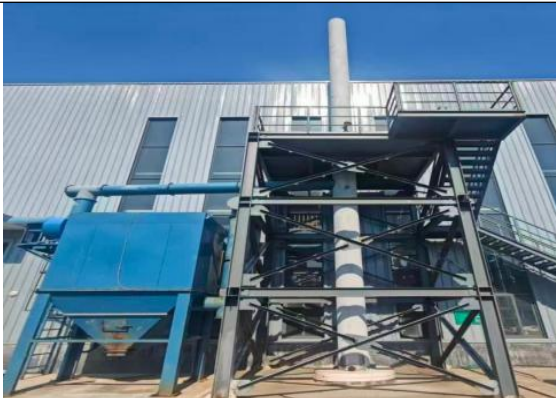
掺混肥环保处理设施及排气筒
