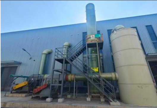
挤压造粒复合肥排气筒
